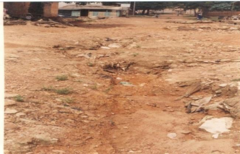
Photo 2: L'état défectueux de la voirie à Dioulakro
