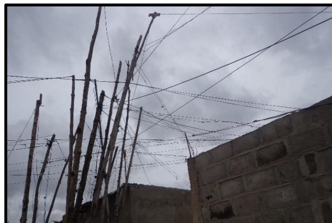
Photo 1 : Mode de fourniture anarchique en électricité au quartier Kokangbakro
